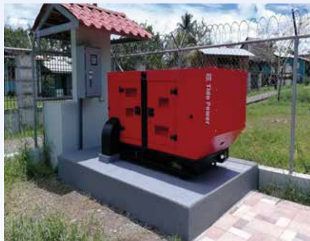
Planta Eléctrica de Kankintú
